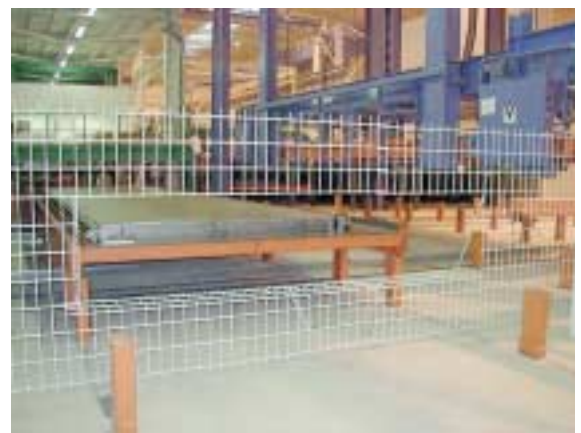
Bild 4. Schutzzaun mit Öffnung und erschwertem Durchstieg Fig. 4. Protective fence with opening and difficult access
