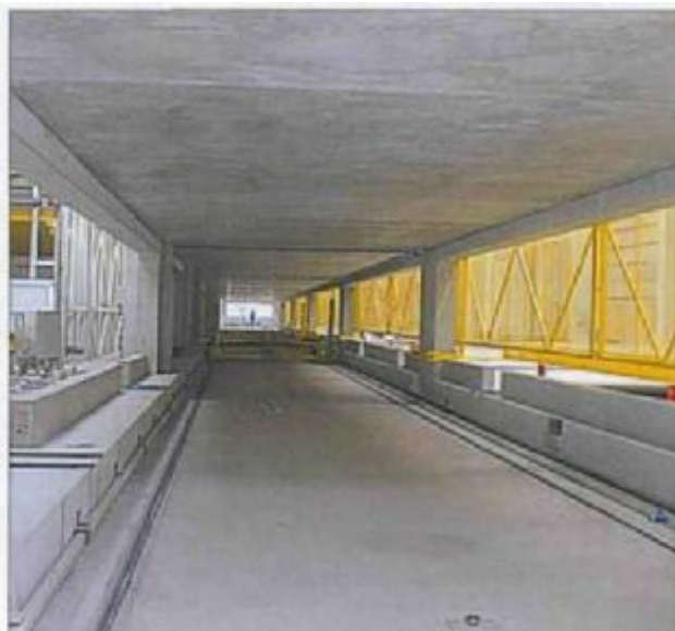
Центральный откатный мост погружного типа в коридоре
