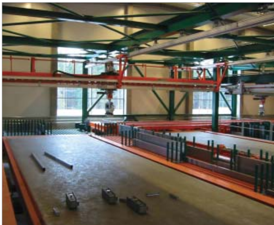
Schalungsroboter und Magazinroboter während der Inbetriebnahme
