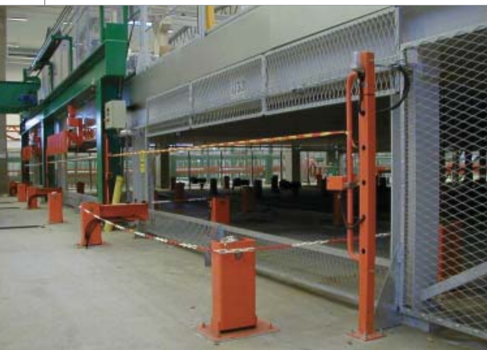
Eine Lichtschranke sichert die Palettendurchfahrt ab
