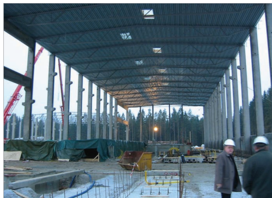
Der Aufbau der Anlage
