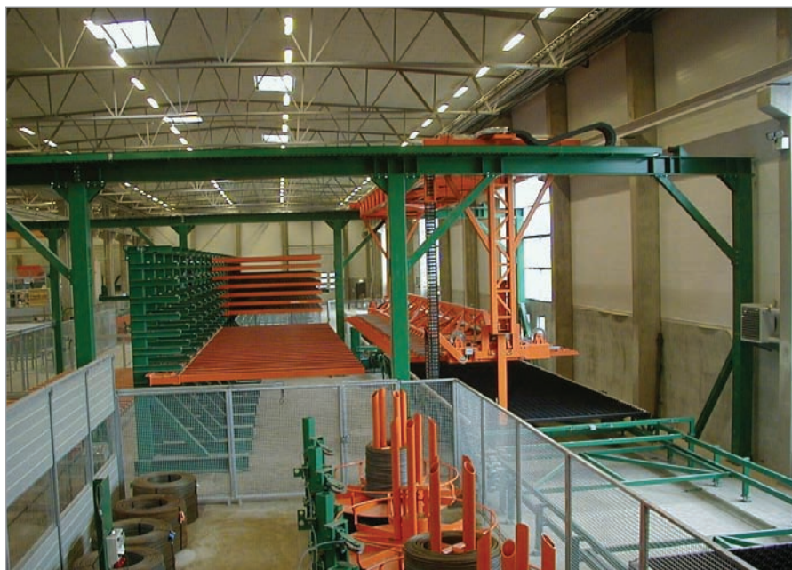
Die Mattenschweißanlage und das Mattenlager
