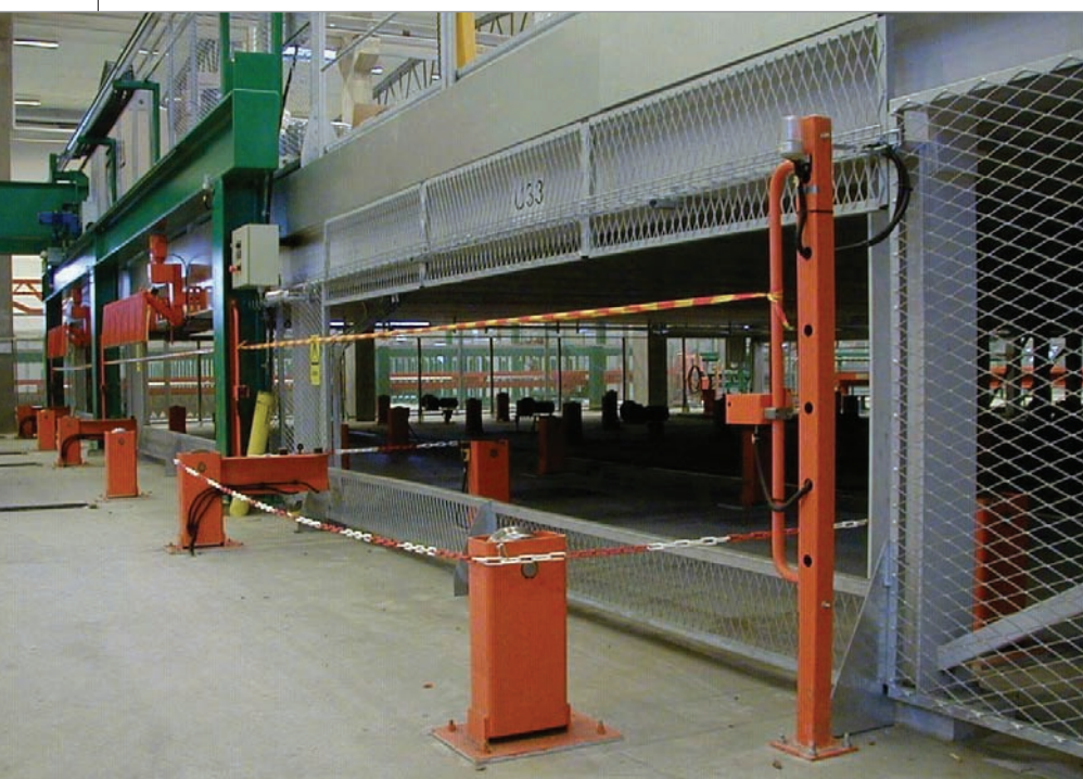
Eine Lichtschranke sichert die Palettendurchfahrt ab
