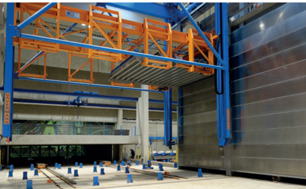
Fig. 3: Transelevador para la alimentación de la cámara de curado
