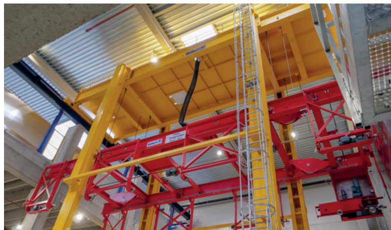
Рис. 8. На следующем этапе расширения на промежуточном уровне будет установлена линия облагораживания поверхности, обслуживаемая стеллажным штабелером Vario Store
