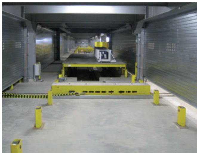
Fig. 18: Paletas y transbordador central dentro del túnel
