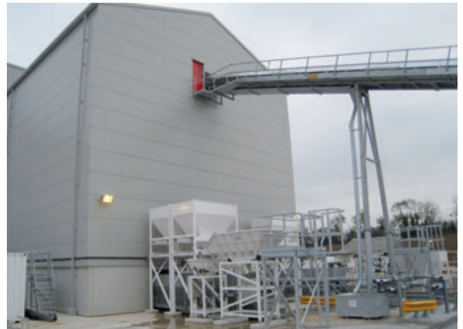
Fig. 36: Planta de hormigón de Skako
