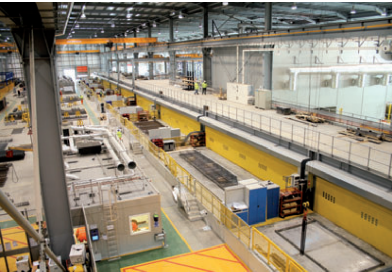
Fig. 3: Vista general 1 Circuito de carrusel para productos especiales (BSC)
