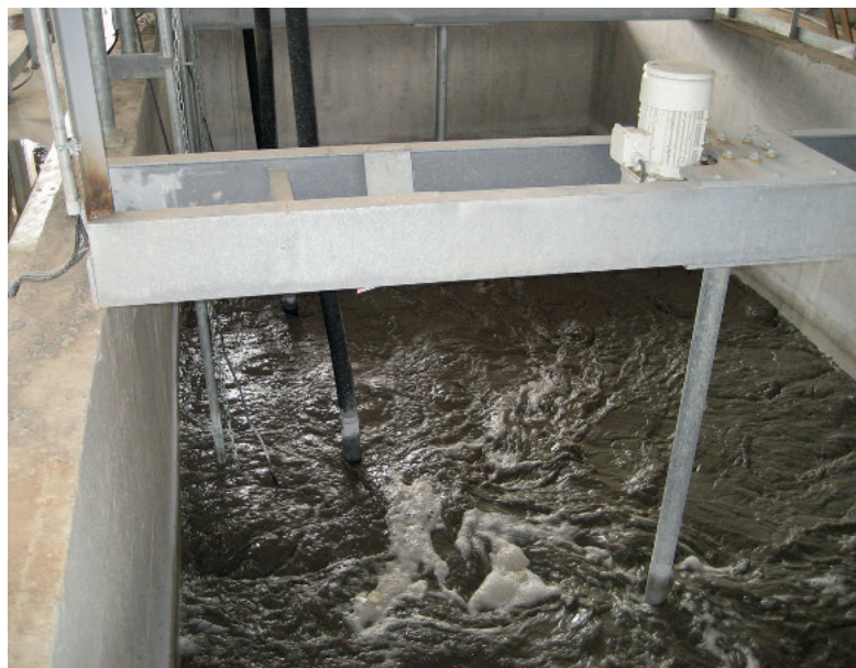
Завихрители в резервуарах системы вторичной переработки Bibco
