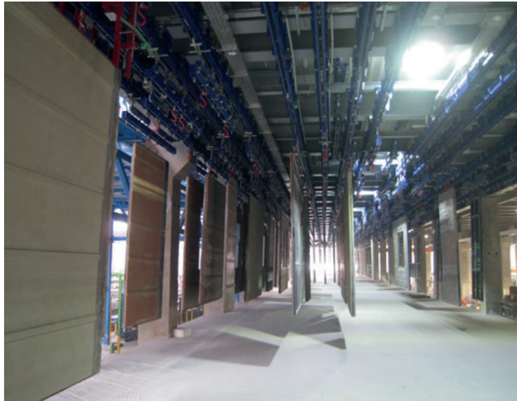
Almacén activo de matrices (Power and Free)
