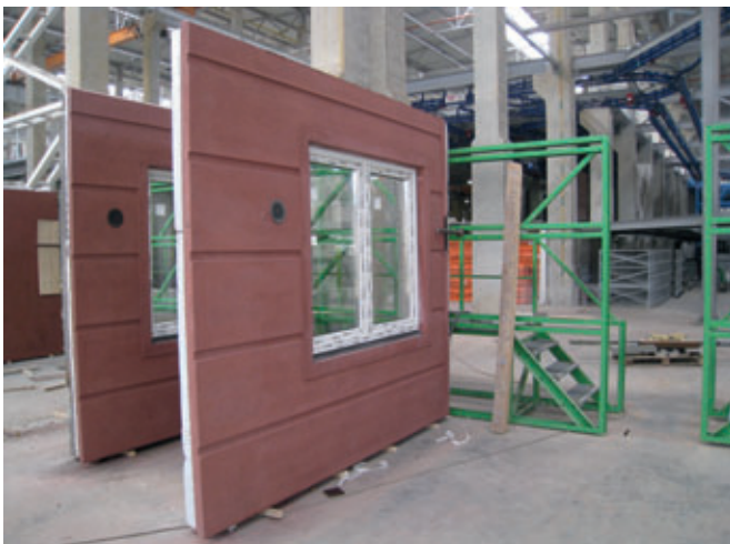
Zona de acabado
