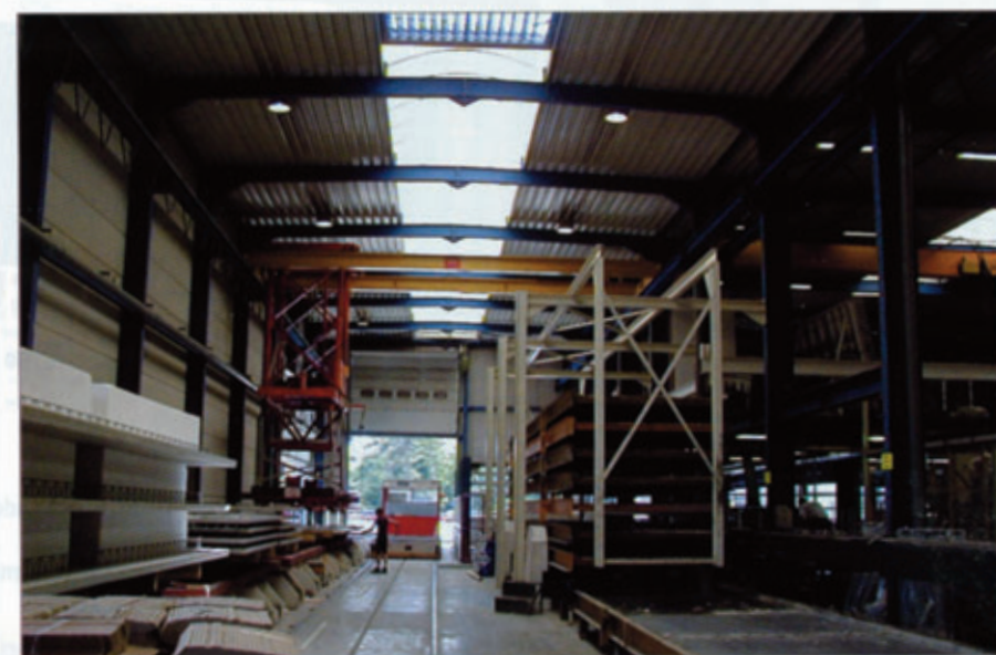
El área de desencofrado con el almacén intermedio para paletas situado delante del robot de encofrado
