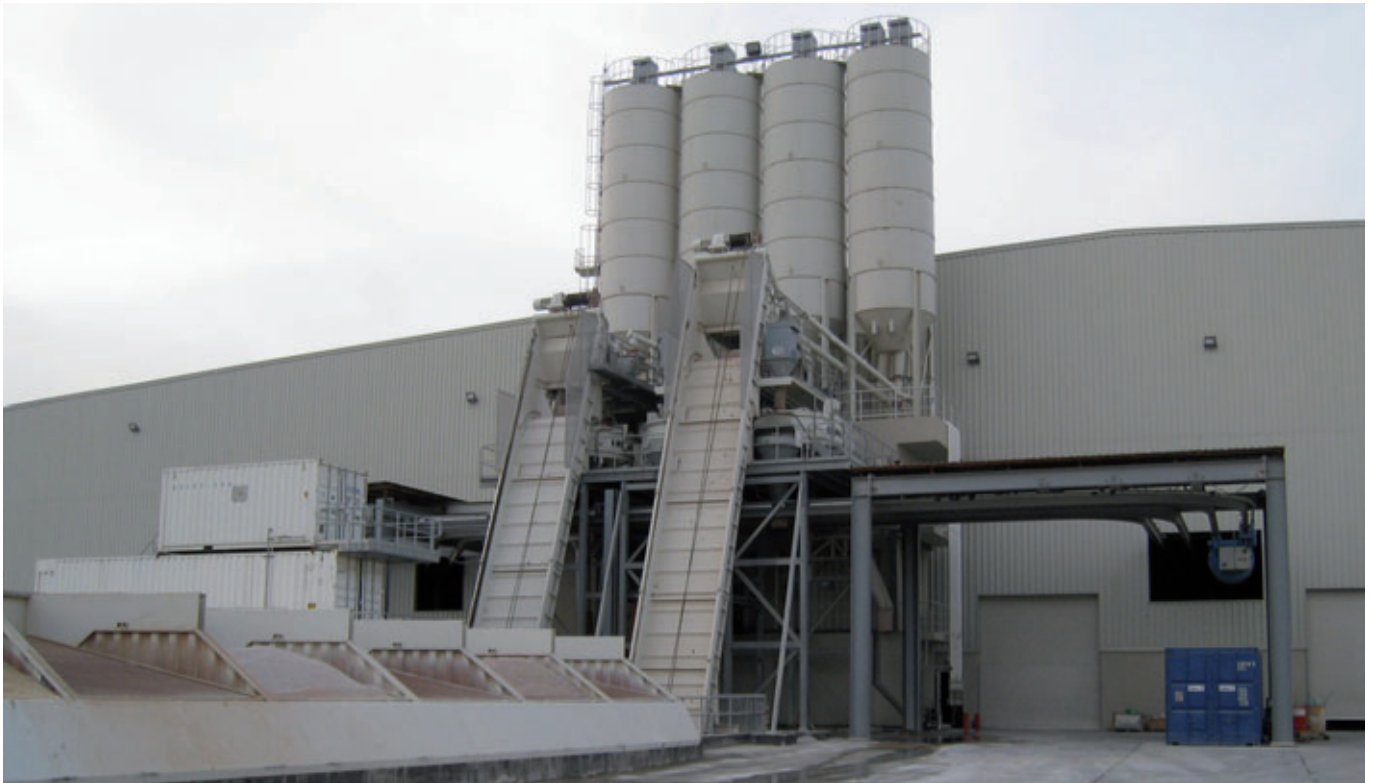
Instalación mezcladora y sistema de transporte de hormigón
