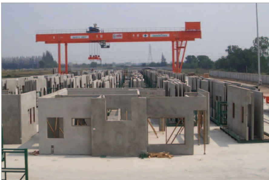
Grúa pórtico y recinto de almacenamiento
