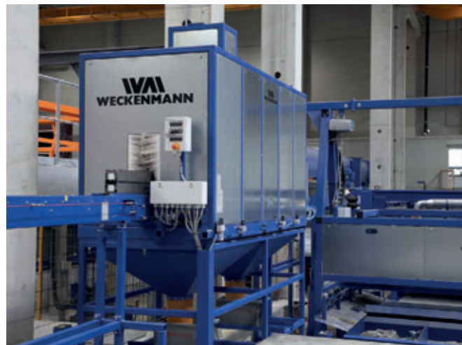
На станции очистки производится очистка и смазка опалубки, которая затем подается в магазин опалубочного робота в соответствии со своей идентификации
