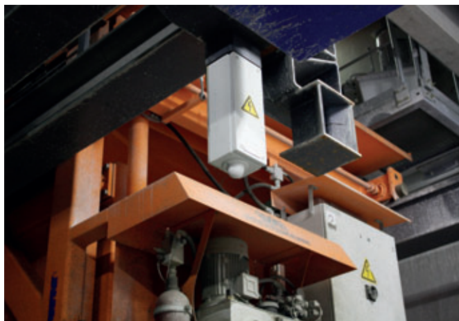
Антенна IWLAN на бетонораздатчике
